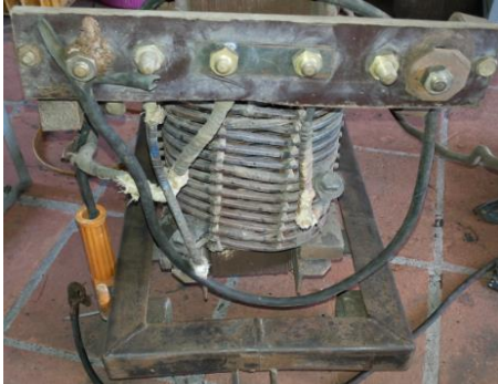
Hình 2.1.8: Cầu đấu điện cuộn thứ cấp với kìm hàn
