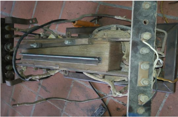
Hình 3.3.1: Hệ thống kết nối cáp cuộn sơ cấp
