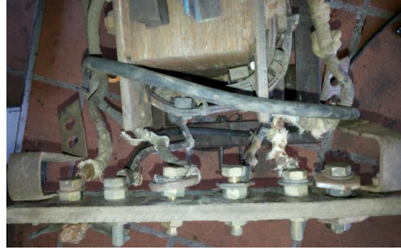
Hình 3.3.2: Hệ thống kết nối cáp hàn cuộn thứ cấp
